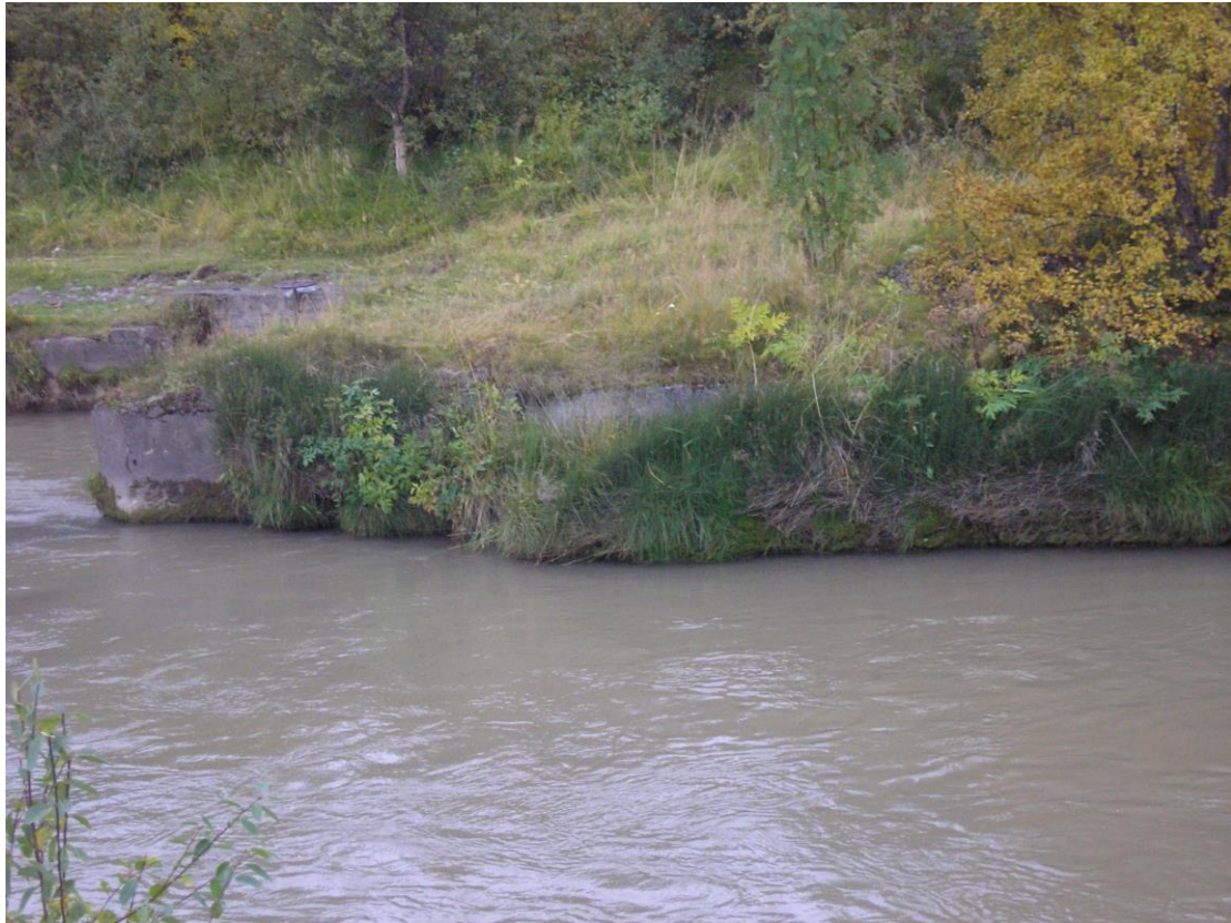
Mynd nr. 18 stífluveggurinn ofan vatnsinntaksins gróðri hulin.
