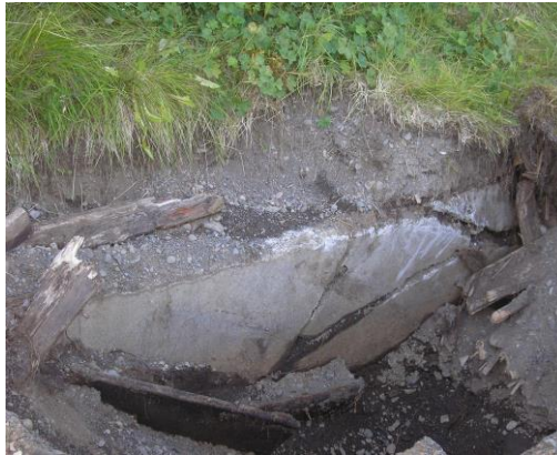
Mynd nr. 7 sprunginn stökkveggur
